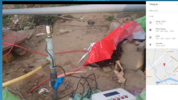
Tuyến ống D114 uPVC đường Trần Vĩnh Kiết Chiều dài : 1000m (Dự án Nâng cấp đô thị TPCT)
